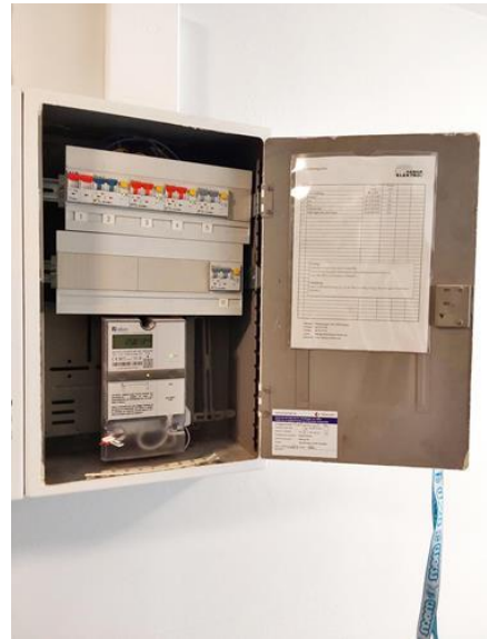
Elektrisk anlegg - [Sikringsskap Storhamargata 24A]
