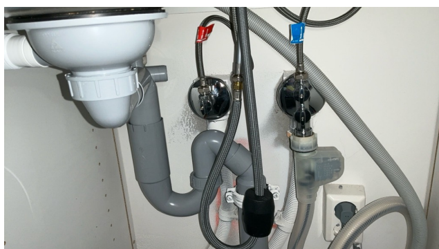
Avløp vask kjøkken
