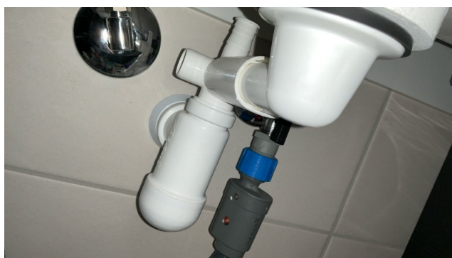
Avløp servant bad
