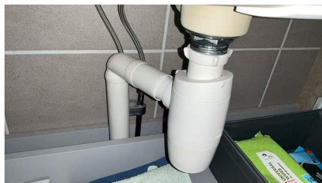
Avløp servant bad
