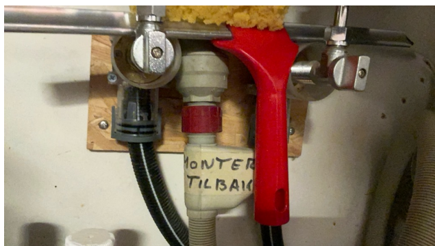
Vannrør i kjøkkenskap
