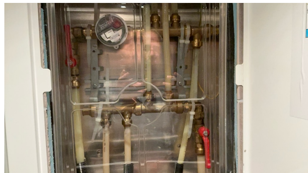
Fordelerskap i bad
