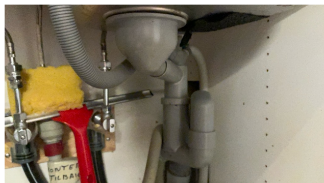
Avløp vask kjøkken
