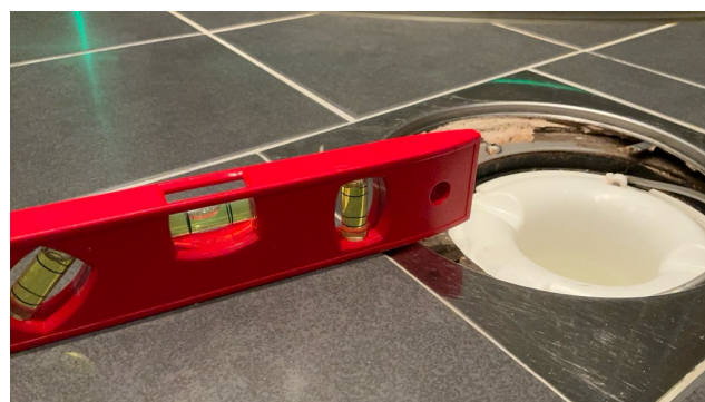
Synlig fall gulv i dusjsonen
