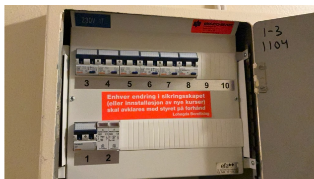
Sikringsskap i felles gang
