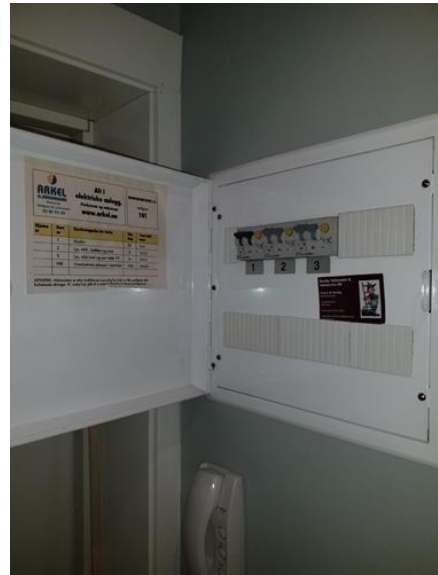
Elektrisk anlegg - [Sikringsskap ]
