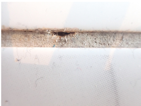
Åpen fuge på vegg i dusj.
