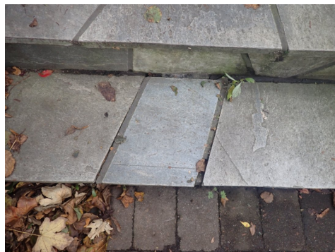
Det er flere skiferheller på trapp til hovedinngang som er løsnet fra underlaget.
