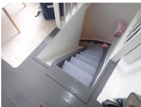
Trapp til loft mangler rekkverk og nødvendig sikring ved repo
