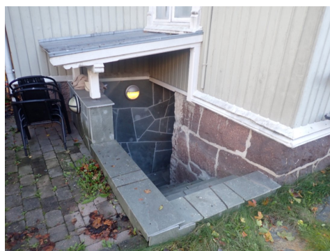
Trapp til kjellerleilighet mangler rekkverk.
