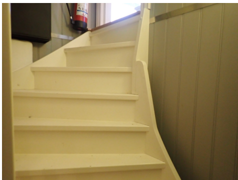
Trapp til vaskerom mangler rekkverk.
