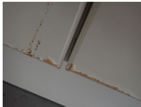
Skadet overflate på dører
