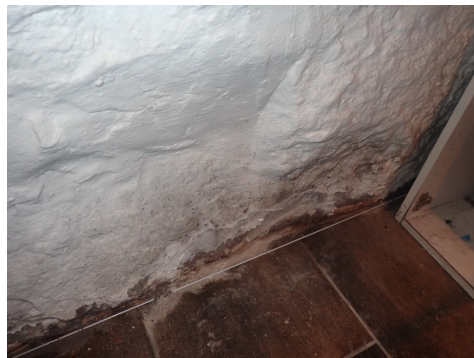
Saltutslag på åpen mur i vaskerom
