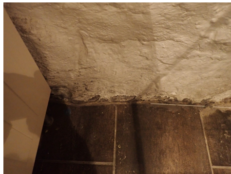
Saltutslag på åpen mur i vaskerom
