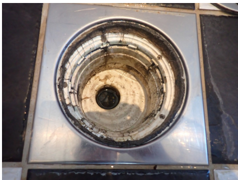
Det er påvist manglende membran i sluket
