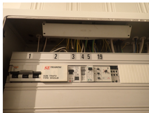
Det er åpent inn i skap mot ledninger på el-skap i første etasje. Berøringsfare
