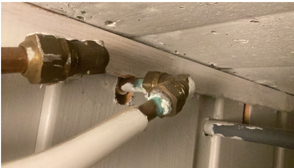
Irr på rør.
