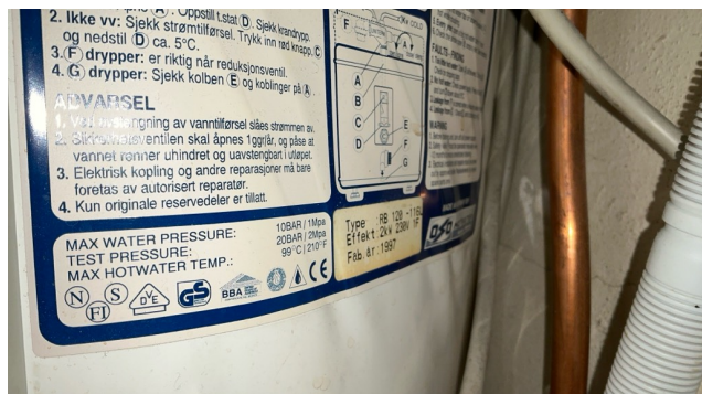
Bereder i kjøkkenskap
