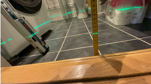
Høydeforskjell (flis ved terskel)
