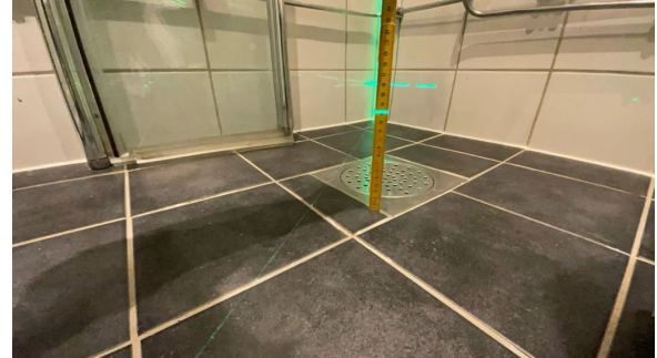
Høydeforskjell (ved sluk)
