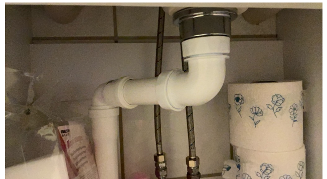
Avløp servant bad
