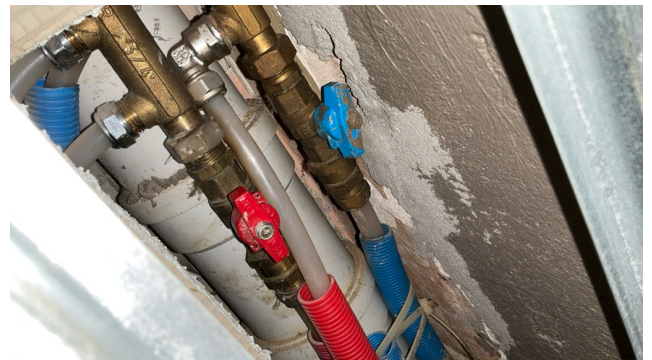
Rørstamme bak luke i vegg bad. Med hopvedstoppekraner.
