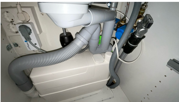
Vannrør i underskap på kjøkken. Lekkasjestopper (blå farge).
