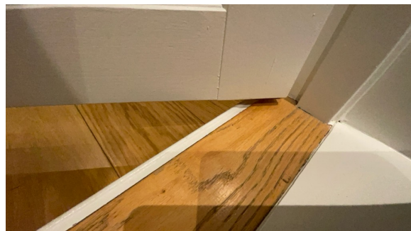
Luftespalte under dørbladet.
