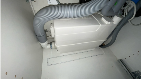
Montert av fagmann, dok. kan fremvises.
