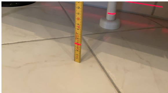
Motfall til dør på ca 7mm fra servant.
