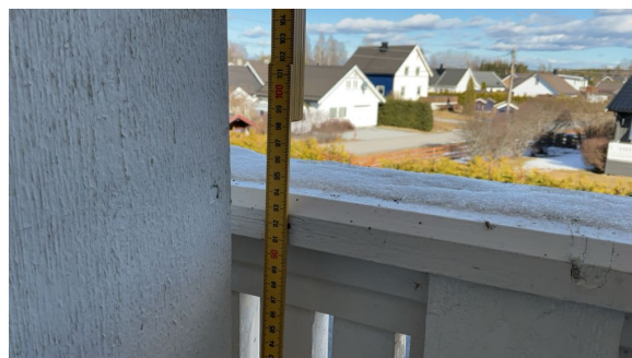
Rekkverk lavere enn 1m på balkong.
