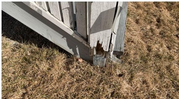
Råte i bord på trapp til terrasse mot sør/vest.
