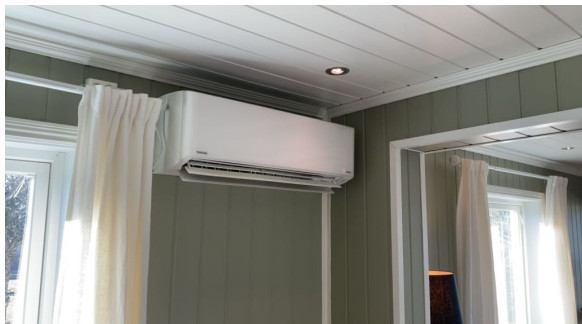
Varmepumpe i stue.
