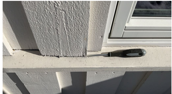
Råte i sidebord på vindu.
