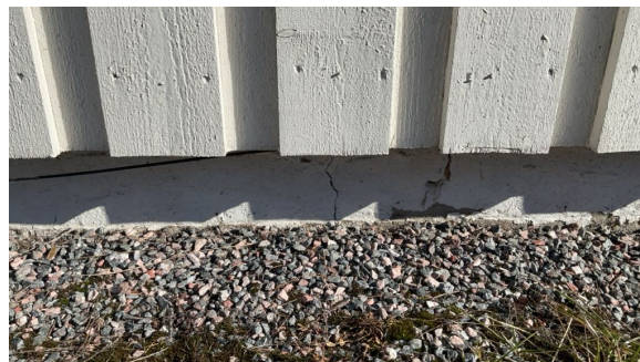
Sprekk i mur.
