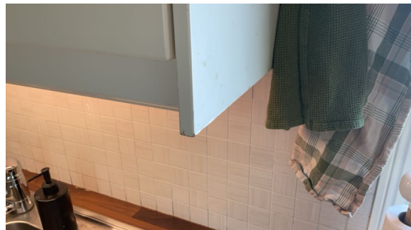
Fukt skadet sideplate over oppvaskmaskin.
