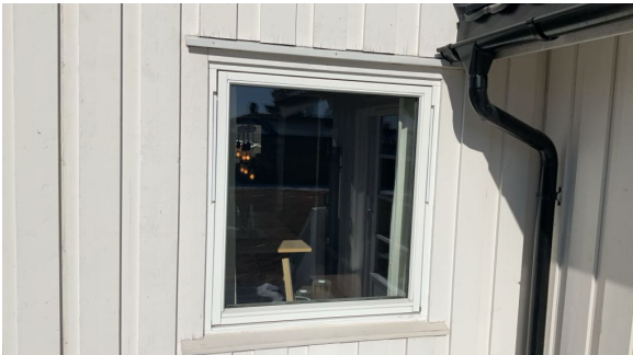
Værslitte bord over og på siden av vindu.
