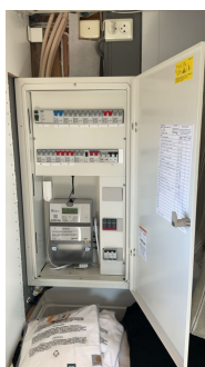
Sikringsskap i garderobeskap i lofts stue.
