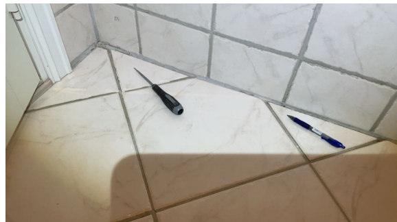
Løse fliser og sprekker i fuging.
