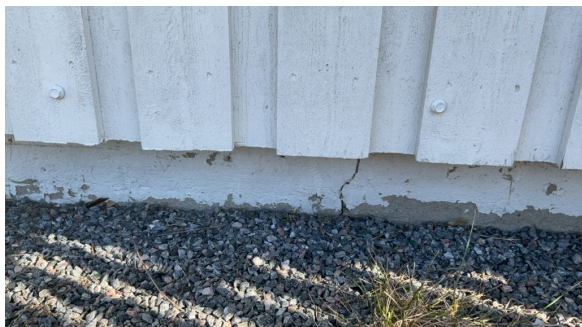
Sprekk og malings flass på mur.
