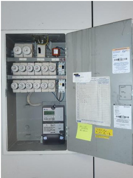
Elektrisk anlegg - [Sikringsskap]
