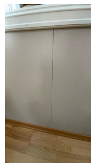
Boligen har enkelte synlige skjøter på vegger og i himlinger
