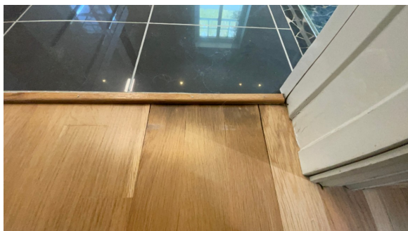
Tidligere fuktskade på gulv ved bad i 2-etasje
