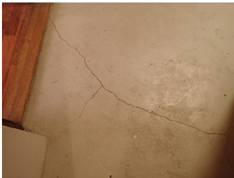
Betonggulv har stedvis sprekker
