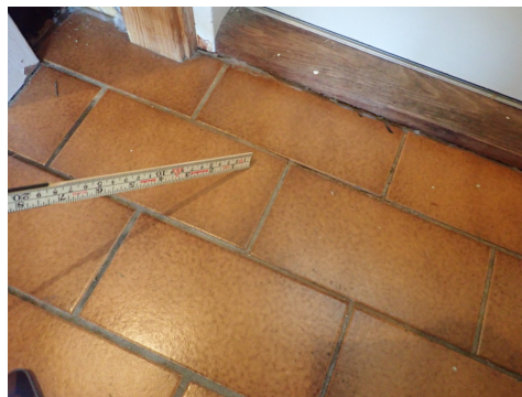
Fliser i entre og gang har løsnet fra underlaget.
