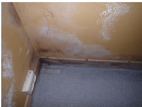
Saltutslag på vegger åpen mur og tapet
