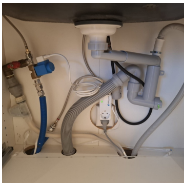
Lekkasjevarsler i benkeskap
