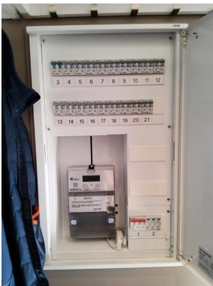
Elektrisk anlegg - [Sikringskap ]
