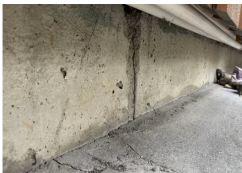
Sprekk i grunnmur.
