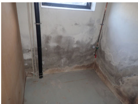
Synlige saltutslag på grunn av fuktgjennomgang i grunnmur
