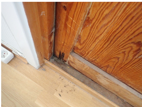
Balkongdør er vanskelig å åpne og lukke.
