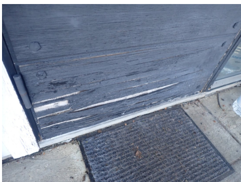
Det er oppsprukket overflate på inngangsdør
