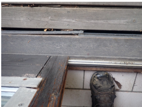
Heve skyvedør i stue er oppsprukket. Beslag har løsnet fra terskel.
