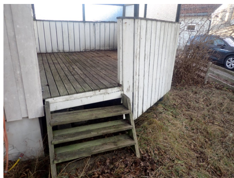
Trapp og terrasse mot sør har skjevheter.
