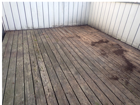
Terrasse mot sør er sliten og værslitt
