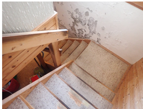
Trapp har ikke tilstrekkelig rekkverk.
