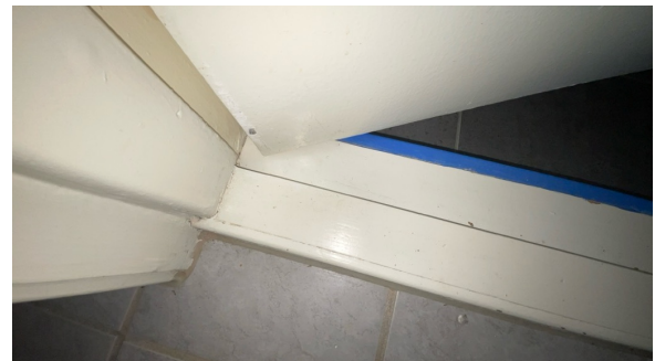
Luftespalte under dørbladet.
