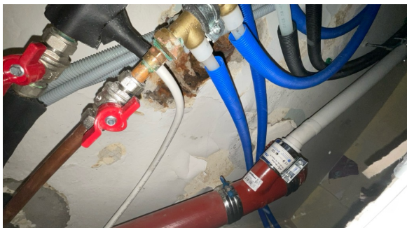
Rørpropplegg over himling på baderom.
