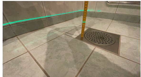
Høydeforskjell (ved sluk)
