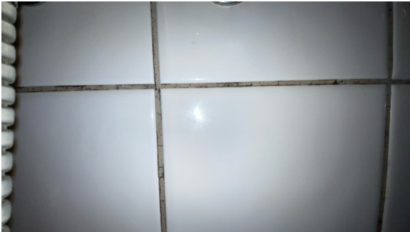
Riss i fuger
