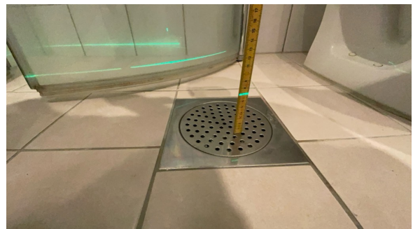
Høydeforskjell (ved sluk)
