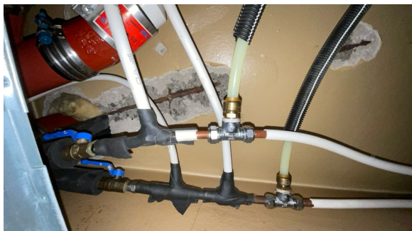
Vannrør og stoppeventiler
