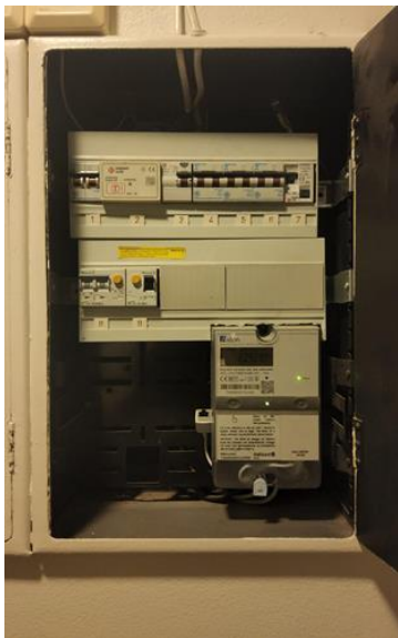
Elektrisk anlegg - [Sikringsskap]
