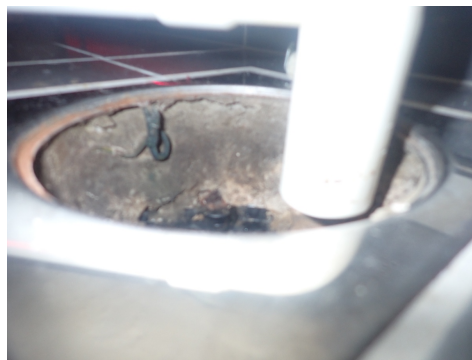
Sluk under dusjkabinett
