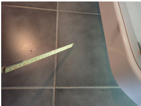
Det er påvist "bom" og hulromslyd på enkelte fliser foran dusjkabinett.
