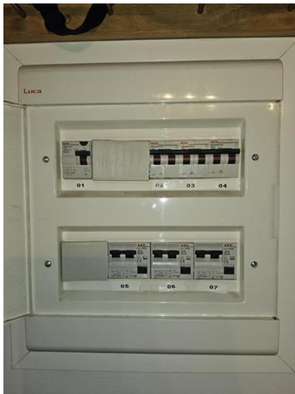
Elektrisk anlegg - [Sikringsskap ]
