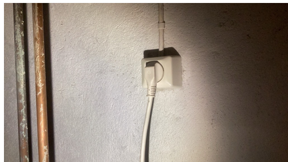
Varmtvannstank yilkoblet med stikkontakt.
