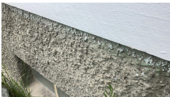
Liten/ingen lufting av panel ned mot grunnmur.
