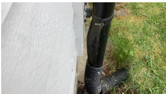
Frostspreng på takrennenedløp.
