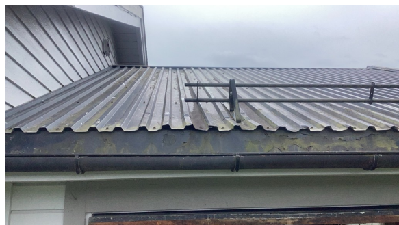
Skade på takteking.
