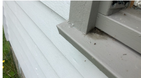
Ingen klaring mellom omramming og vannbrett.
