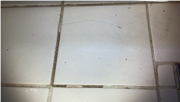
Sprekk i flis og flisfuger.
