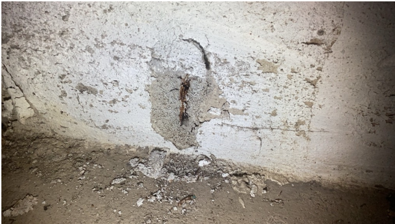
Rust/korrosjon på armering.
