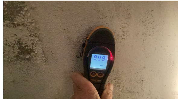
Ved enkle fuktsøk ble det registrert områder med forhøyde verdier.
