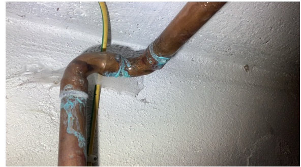
Irr på rør.
