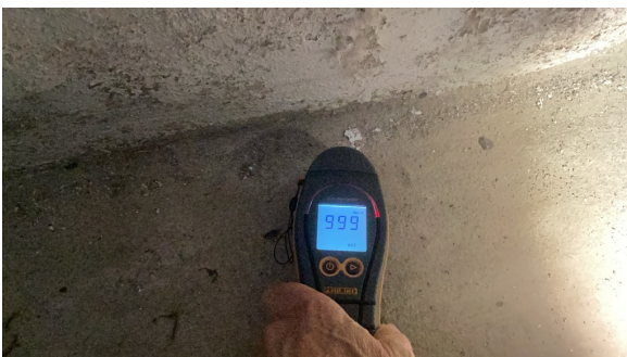
Ved enkle fuktsøk ble det registrert områder med forhøyde verdier.
