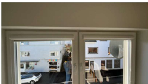
Ingen ventiler i leilighet
