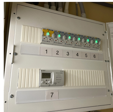
Sikringsskap i underetasje
