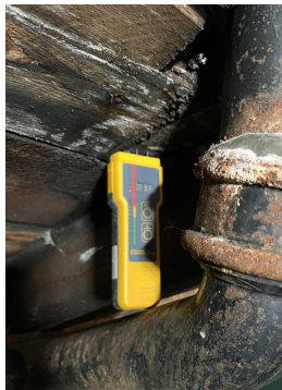
Fukt/råte i treverk rundt lufterør for kloakk.
