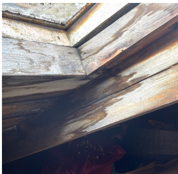
Fukt i treverk rundt gammel takluke
