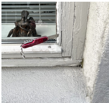
Råte i omramming rundt vindu mot syd i underetasje
