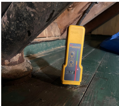
Fukt i gulv i samme område
