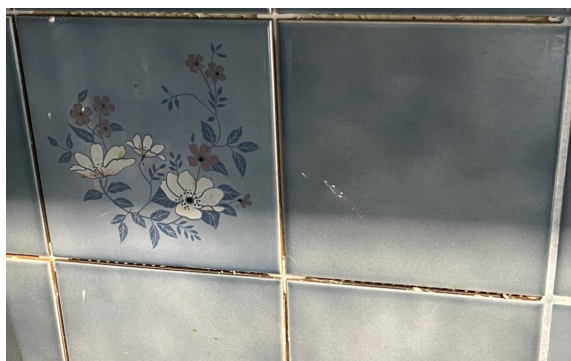
Manglende fuger mellom flere fliser
