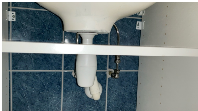
Avløp servant bad hoved.
