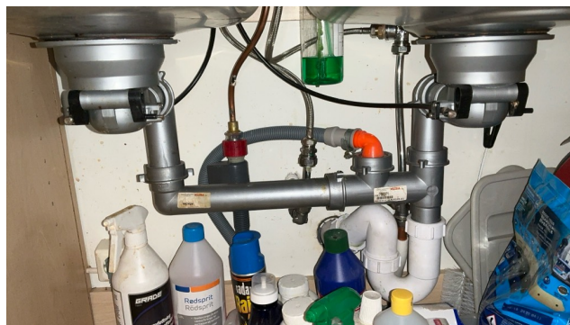
Avløp vask kjøkken
