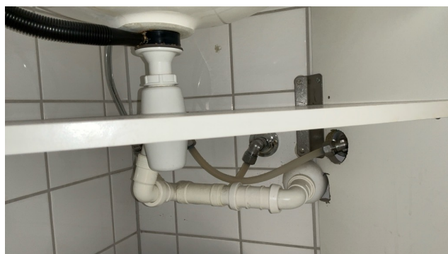
Avløp servant gjestebad.
