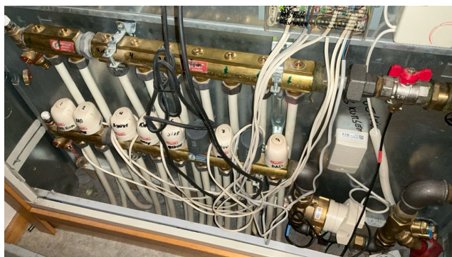
Fordelerskap i bod
