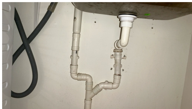
Avløp vask vaskerom
