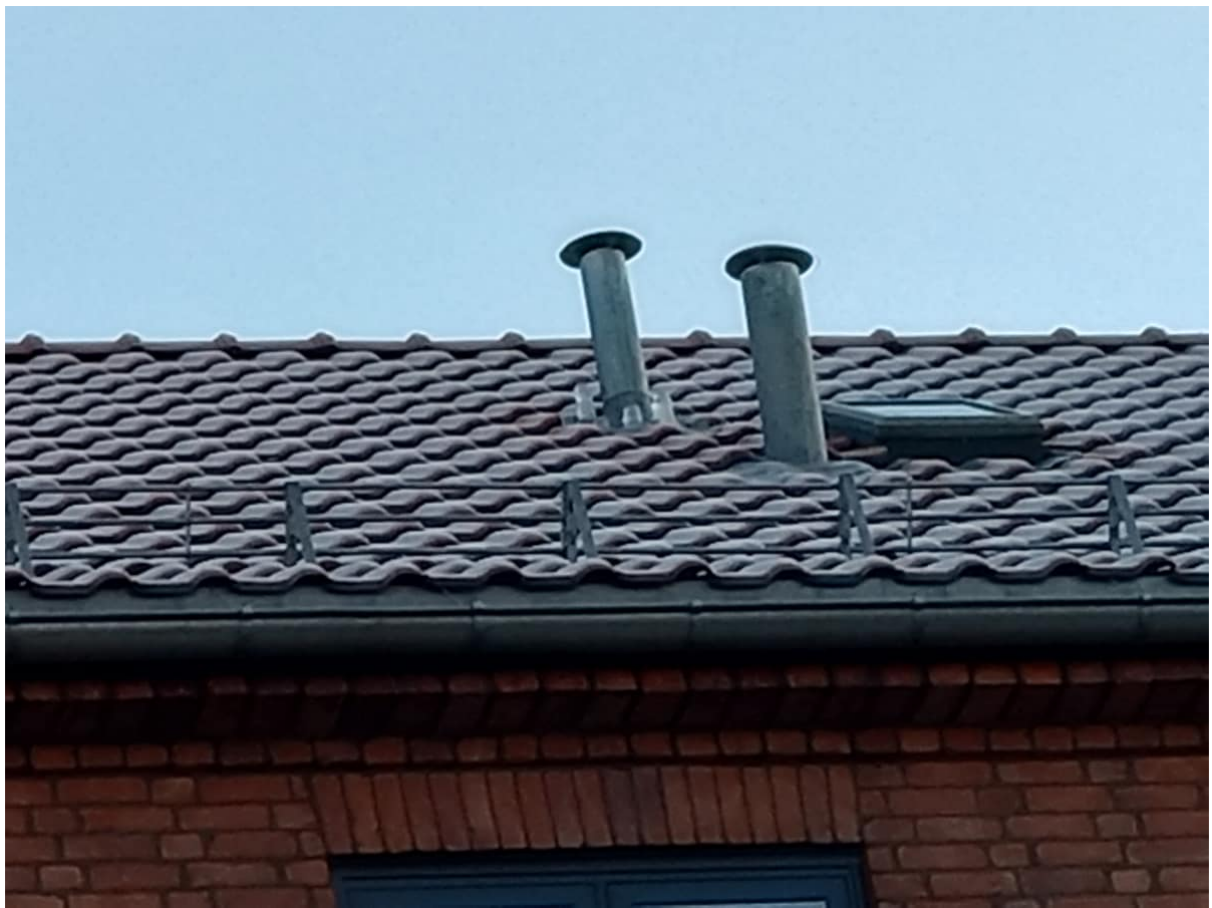
Eksempel på isdannelser på taket - kinahatt på bakerste pipe er nå fjerna
