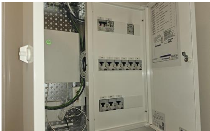
Elektrisk anlegg - [Sikringsskap. ]
