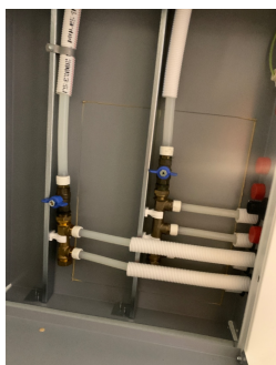
Rørskap i bad. Stoppekraner for bad plassert i dette skapet
