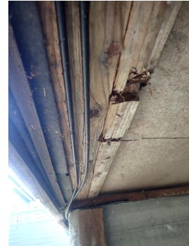
Plater i stubbloft er misfarget og til-løp til råteskadet i området - overgang gulv og yttervegg.
