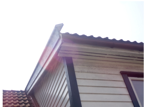
Vindskier på oppløft har skjevhet utover.
