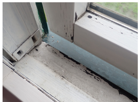
Værslitt vindu på takoppløft i 2. etasje.
