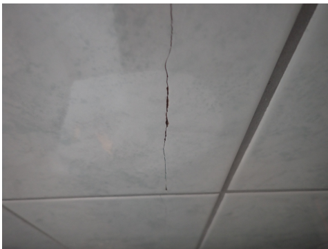
Fliser har sprukket på vegg under vindu
