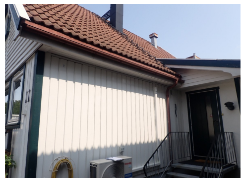
Det mangler snøfangere og sikring av tak over inngangsparti.
