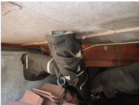
Åpent røranlegg under åpent kryperom.
