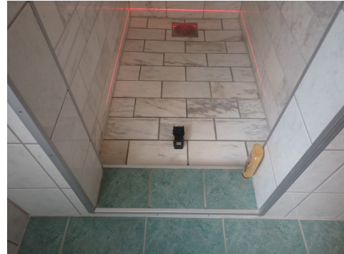
Det er oppkant inn til dusj
