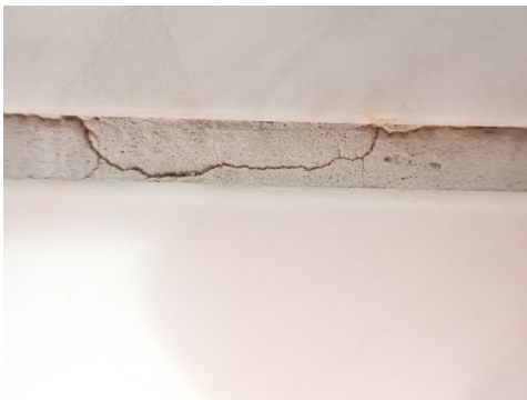
Riss i fuger på vegg i dusjsone
