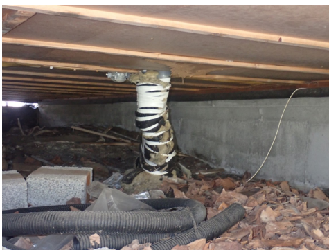
Det mangler tilstrekkelig isolering og omslag rundt avløpsrør under boligen.
