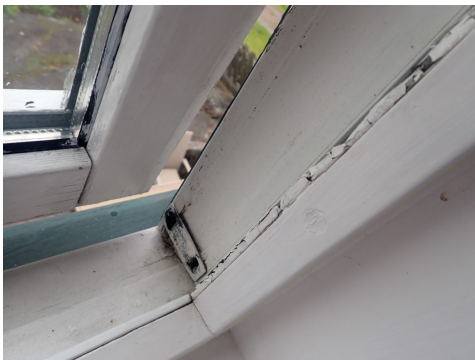
Tettelst er skadet. Gjelder flere vinduer.
