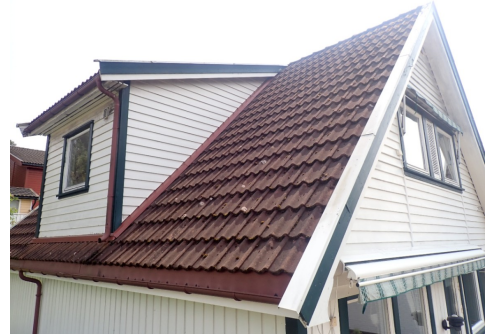
Takstein er stedvis noe mosegrodd
