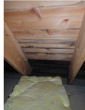
Skjolder i undertak på kryploft.
