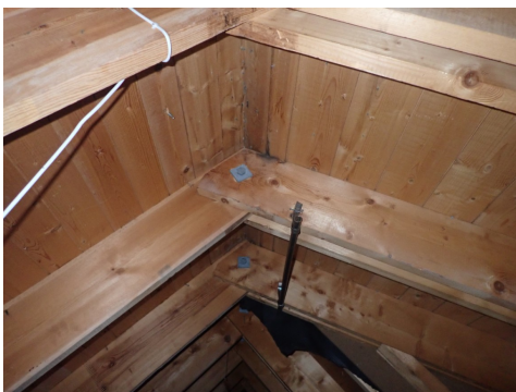
Misfarget og skjolder i undertak ved møne.
