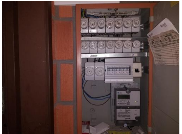
Elektrisk anlegg - [Sikringskapp. ]
