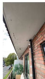
Noe rustsprengning og avskalling på undersiden av balkongdekket over.
