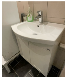
Knotter på servantskap mangler.
