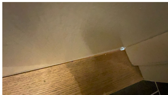
Manglende luftespalte under dørbladet.
