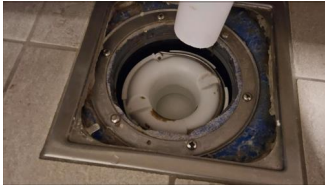
Avløp (inkl. sluk) - Sluk bad 2 etasje
