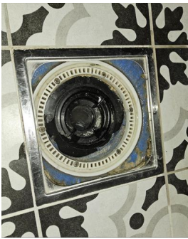
Avløp (inkl. sluk) - Sluk vaskerom 1 etasje
