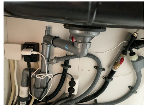
Avløp vask kjøkken
