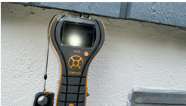
Måling med pigg for fuktkontroll endebord. Normale verdier registrert.
