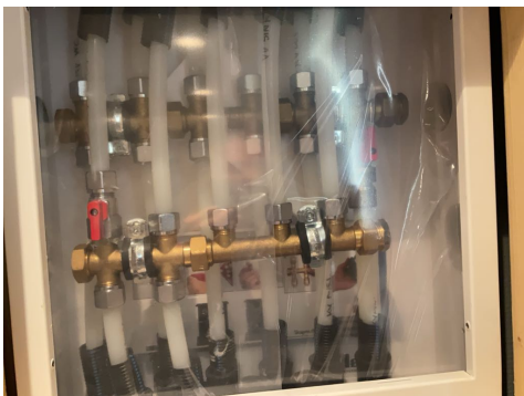
Fordelerskap i bad underetasje
