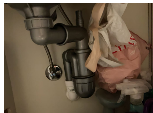
Avløp vask vaskerom
