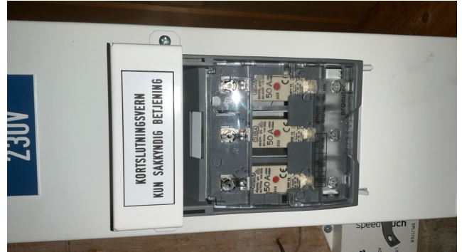
Kortslutningsvern på loft.
