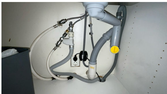
Rør på kjøkken.
