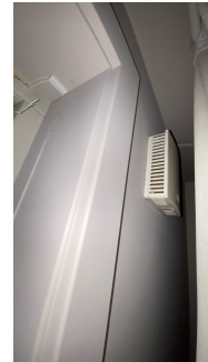
Lufteluke i yttervegg på soverommet.
