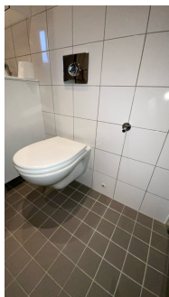
Toalett. Drensspalte til høyre for toalettet.
