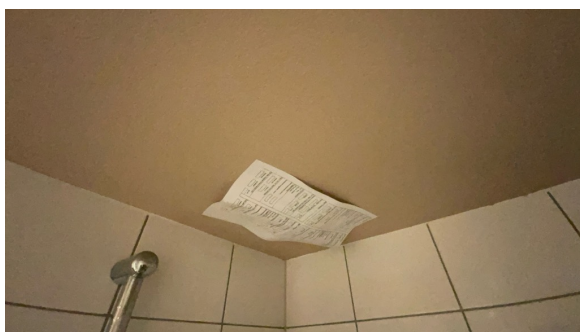
Test med løst ark viste tilfredsstillende avtrekk.
