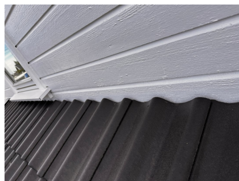
Manglende beslag mellom tak og vegg
