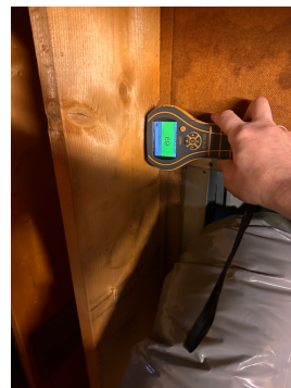
Måling av fuktighet i sperr, ingen utslag.
