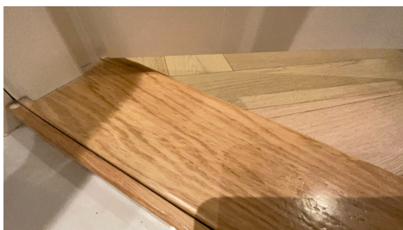
Luftespalte under dørbladet.
