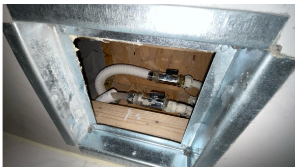
Originale kobberør (høyre side av bildet) innenfor inspeksjonsluke på baderommet. Nyere plastrør på venstre side.
