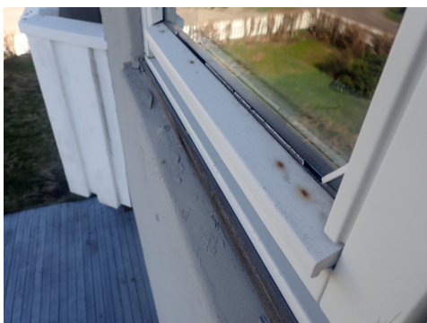
Tettelister mot glasset har løsnet flere steder
