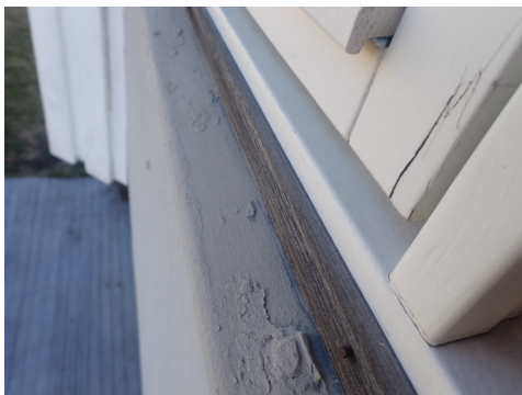
Vinduer er stedvis oppsprukket
