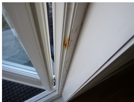
Div. skader på balkongdør ut fra stue.
