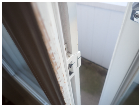
Det er skader på karm balkongdør i 2. etasje
