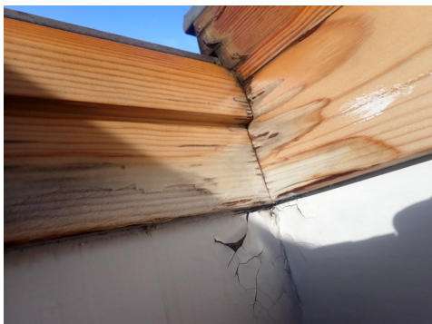
Takvindu er tydelig skadet i hjørner. Skyldes fukt/kondens.
