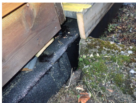
Det er usikkerhet rundt tetting av terrasse over garasje i overgang yttervegg.
