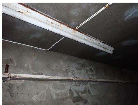
Det er påvist fukt og saltutslag i garasjerom
