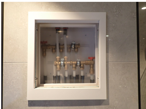
Rørskap på bad/vaskerom
