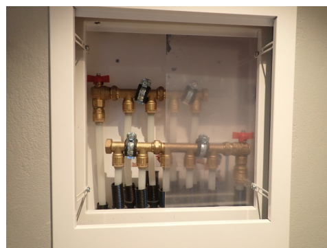
Rørskap på bad.
