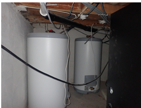
Krypkjeller med varmtvannsberedere.
