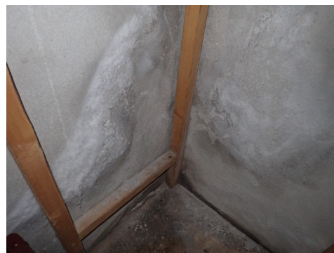
Saltutslag på åpen mur i bod
