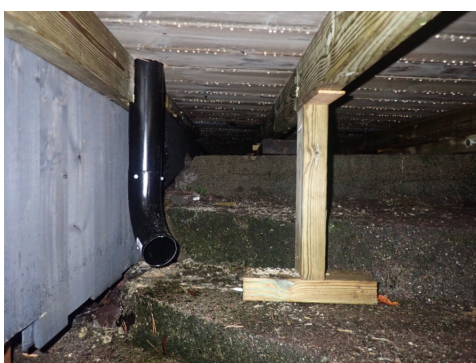
Terrasse har understøttelse direkte mot terreng uten fundament.
