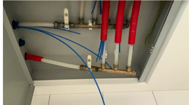
Fordelerskapp i tak bad. Fordelerstamme løs
