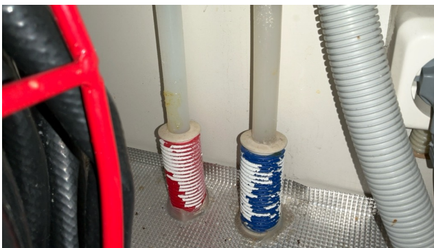
Vann tilførsel kjøkken
