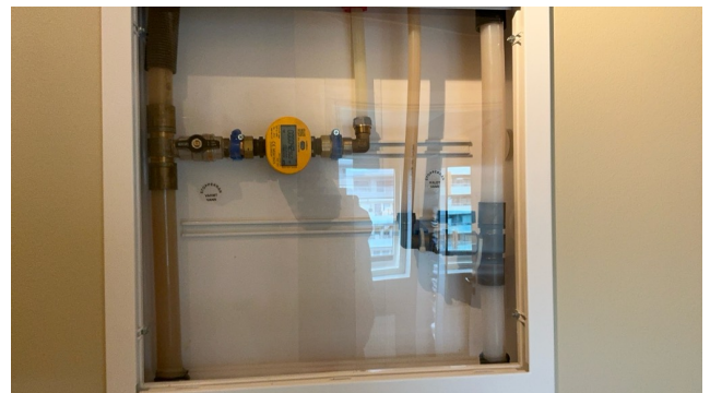
Hovedstoppekraner i skap gang.
