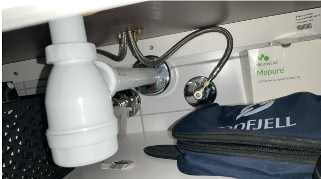
Avløp servant bad
