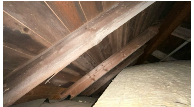
Synlig missfarget undertak.
