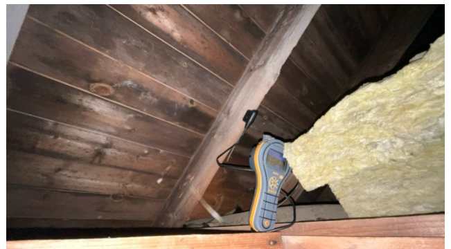
Utført fuktmålinger i taksperer der det ikke ble påvist høy fuktprosent og konstruksjoner fremstår som tørr på befaringsdagen.
