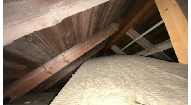
Synlig missfarget undertak.
