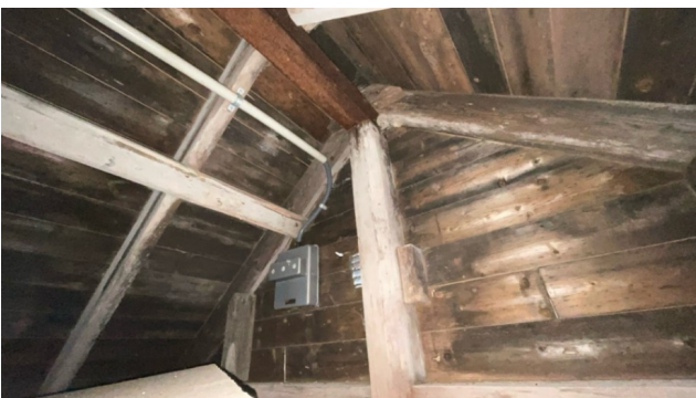
Synlig missfarget undertak og stedvis soppdannelser.
