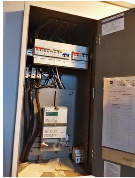
Elektrisk anlegg - [Sikringsskap]
