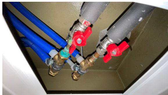
Rør over himling på baderommet.
