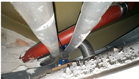
Rør over himling på baderommet.
