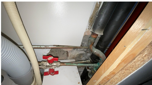
Rør i underskap på kjøkken.
