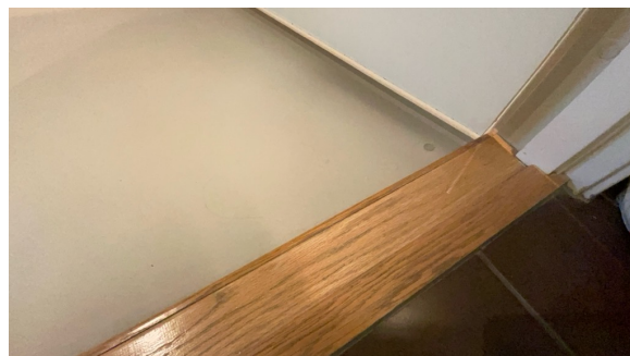
Luftespalte under dørbladet.
