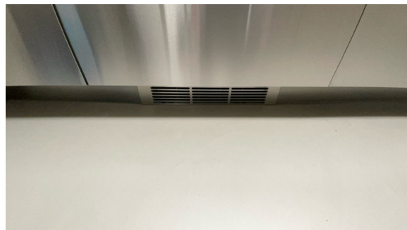
Utkast for avtrekksluften kommer ut her.
