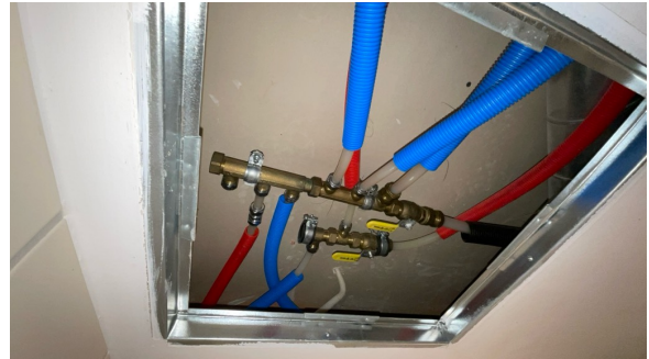
Samlestokk over himling på baderom. Stoppekraner.
