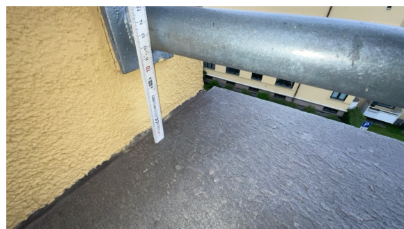
Åpning i rekkverk er større enn 10cm.
