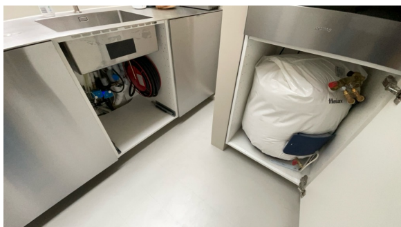
Bereder. Lekkasjestopper magnetventil.
