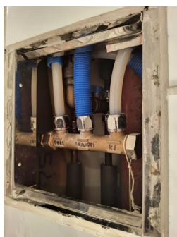
Innvendig stoppekran - Fordelerskammer i kasse på bad
