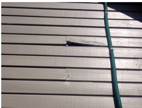
Det er spredte råteskader på fasade sør.
