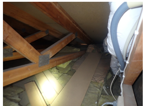
Det er påvist noe manglende lufting fra loft mot gesims.
