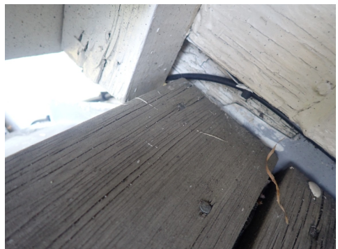
Det er usikker membran på balkonggulv på sidene ut mot tak/overgang til tak.
