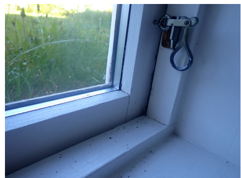
Værslitt og sprekk i vindu underetasje
