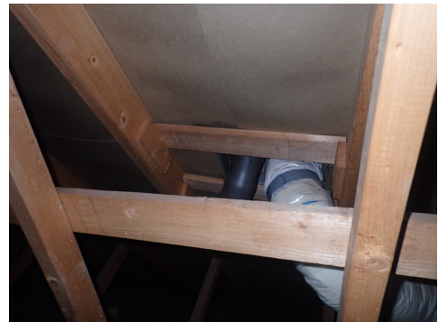
Påvist skjolder i undertak ved kanalgjennomføring
