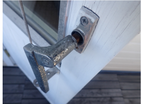
Ødelagt vrider på balkongdør i 2. etasje
