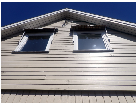
Værslitt og noe oppsprukken kledning på fasade sør.
