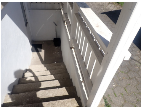
Trapp til underetasje. Muren er skjev.
