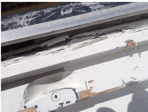
Vindu mot sør i 2. etasje. Værslitt og sprekker.
