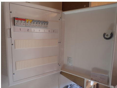
El skap i underetasje mangler kursoversikt
