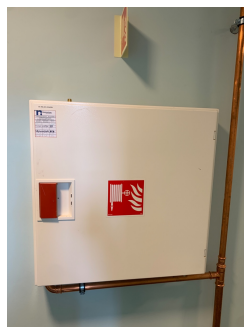
Brannslange like utenfor inngangsdøren
