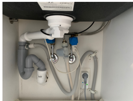
Rørapplegget i kjøkkenet
