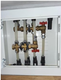
Fordelerskap og fordelerstammer - Fordelerskap
